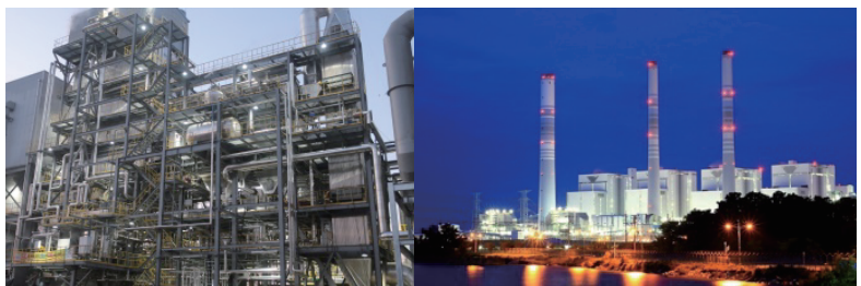
* 소각로와 화력발전 설비 전경
